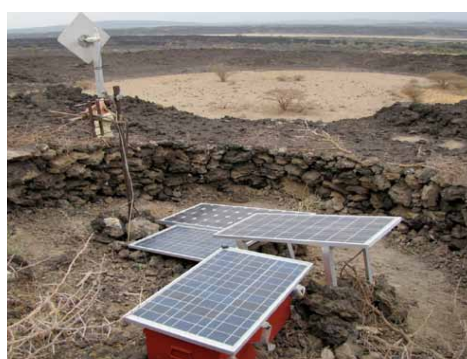
Station autonome dans la région des Afars en Ethiopie, alimentée par des panneaux solaires.
