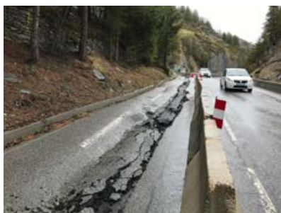
Déformation de surfaces observées sur la RD947 et l'ouvrage digue sur le tracé du Guil. Un soulèvement en compression proche de 50 cm est observé par endroits. Crédits : J.P. Malet
